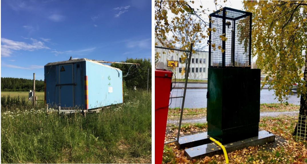
Figur 1. Mätstation Norr Malma, strax norr om Norrtälje, mätutrustningen är placerad i en mätvagn (vänster bild). Mätstation på Sollentunavägen 192 i Sollentuna, mätutrustningen är placerad i ett mätskåp med bur som skyddar insug (höger bild).
